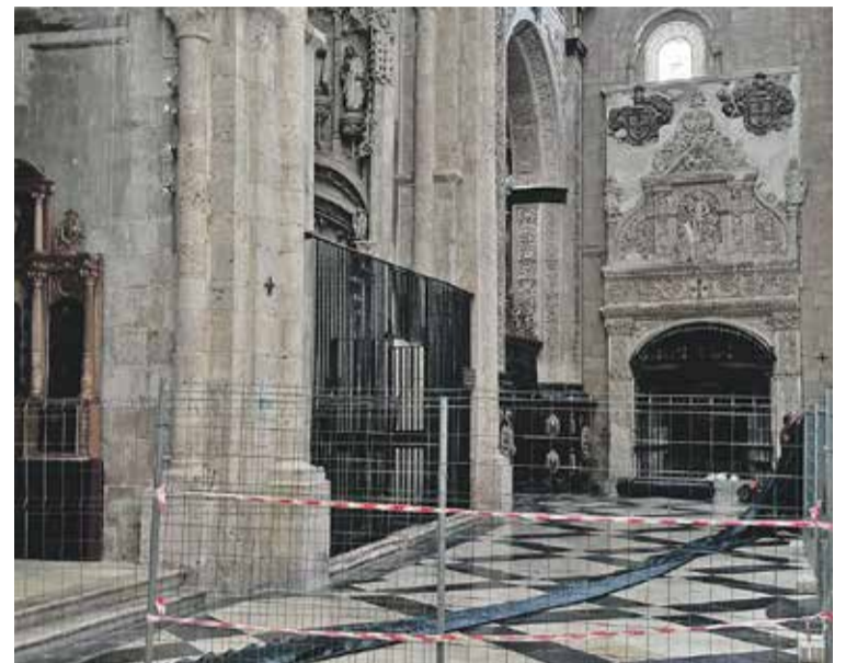
Foto: Comienzo de las obras en la Capilla de los Corporales. UP Daroca
