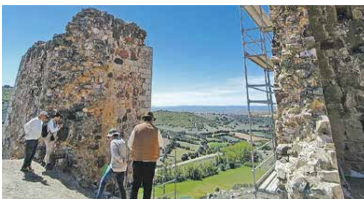
Foto: Visita a las obras del Castillo de Santed. Turismo Comarca de Daroca
